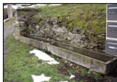
Photo 48: Saint-Lary, abreuvoir en béton mars 2007
