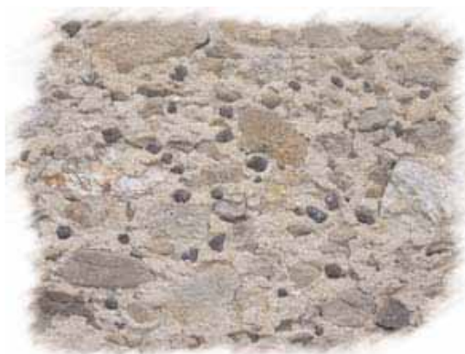
Incrustations de scories dans les joints
