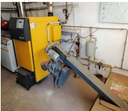
(c) Système de convoyage du combustible au brûleur.
