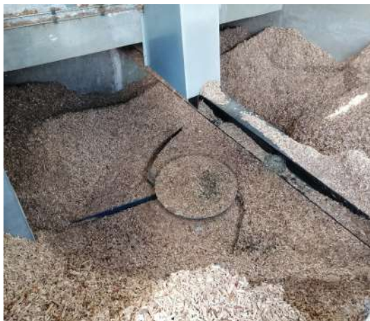
(b) Vue intérieure du silo à biomasse.
